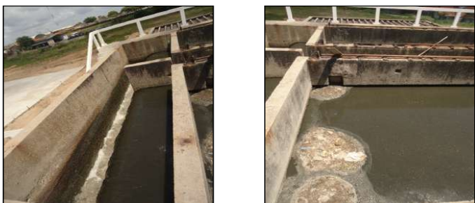
Figuras 85 e 86. Detalhes da Caixa de Areia em funcionamento. Fonte: MJ Engenharia
