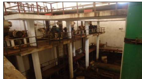
Figura 78. Visão Geral do interior da EEE Emissário Submarino. Fonte: MJ Engenharia.
