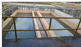
Figura 59. Filtros da ETA Pratygy. Fonte: MJ Engenharia.
