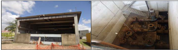
Figuras 94 e 95. Vista geral e dos GMBs da EEE Riacho Salgadinho. Fonte: MJ Engenharia
