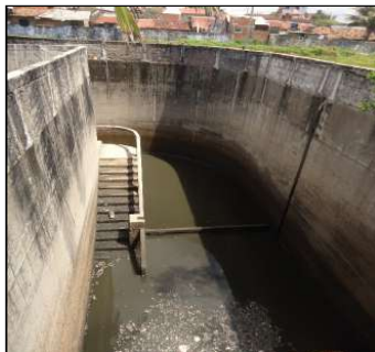
Figura 74. Câmara de chegada da ETE – Disposição Oceânica. Fonte: MJ Engenharia
