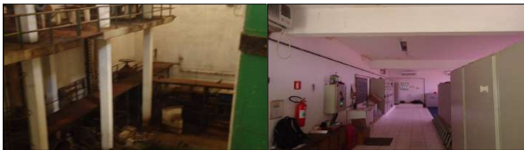
Figuras 81 e 82. Os 2 GMBs que formam o conjunto Emissário III e sala do operador. Fonte: MJ Engenharia
