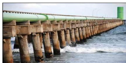
Figura 89. Emissário Submarino de Maceió – trecho de tubulação aérea. Fonte: http://www.tribunahoje.com/vgmidia/imagens/48720_ext_arquivo.jpg (acesso em 05/09/2015)
