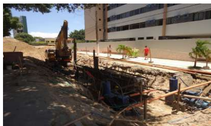
Figura 91. Obras de ampliação da rede coletora de esgotos na bacia Sudeste. Fonte: MJ Engenharia
