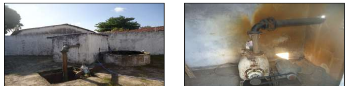
Figuras 105 e 106. Vista geral e do GMB da EEE – Santo Eduardo. Fonte: MJ Engenharia
