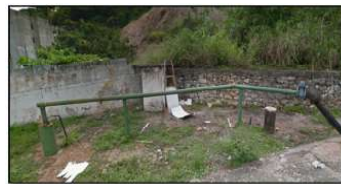
Figura 49. Poço de captação da CASAL
