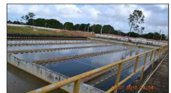
Figura 60. Decantadores. Fonte: MJ Engenharia.
