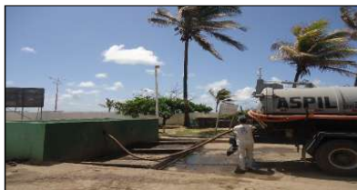
Figura 75. Recebimento de Efluentes de Fossa na Câmara de chegada da ETE. Fonte: MJ Engenharia
