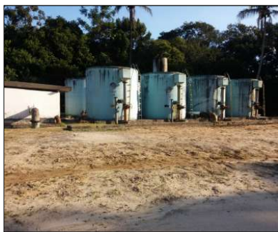
Figura 64. Vista externa dos filtros da ETA. Fonte: MJ Engenharia.
