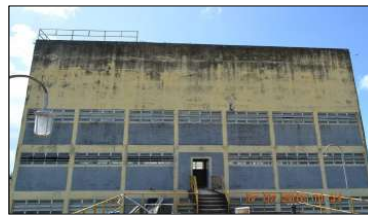
Figura 57. Reservatório de água bruta da ETA. Fonte: MJ Engenharia.
