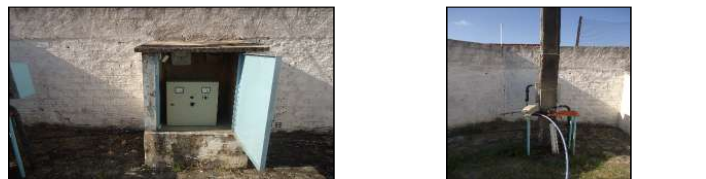
Figuras 107 e 108. Detalhe do quadro de comando e das instalações elétricas da EEE – Santo Eduardo. Fonte: MJ Engenharia
