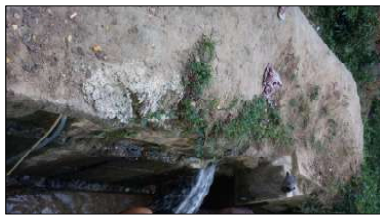
Figura 54. Furtos no Aqueduto Catolé-Cardoso. Fonte: MJ Engenharia.
