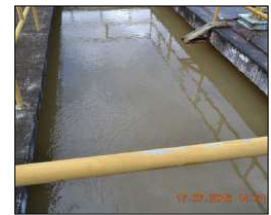
Figura 58. Câmara de Floculação. Fonte: MJ Engenharia.
