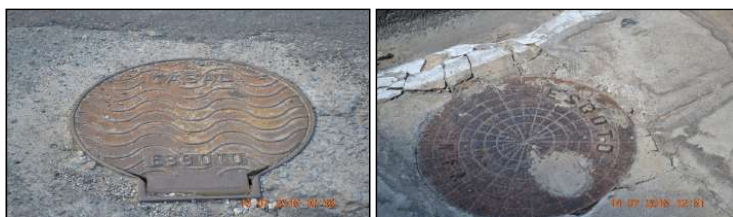
Figuras 122 e 123. Poços de visita da rede coletora existente nos bairros Ponta Grossa e Centro, respectivamente. Fonte: MJ Engenharia
