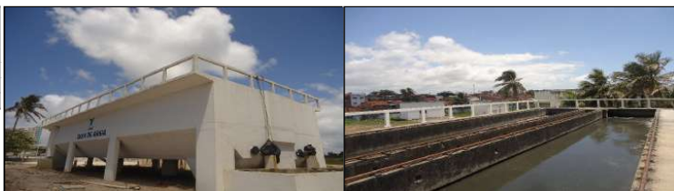
Figuras 83 e 84. Vistas da caixa de areia da ETE – Disposição Oceânica. Fonte: MJ Engenharia
