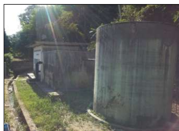
Figura 68. ETA Fernão Velho. Fonte: MJ Engenharia.
