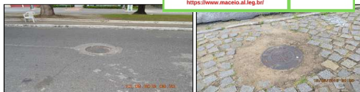
Figuras 92 e 93. Poços de visita da rede coletora existente nos bairros Jaraguá e Pajuçara, respectivamente. Fonte: MJ Engenharia
