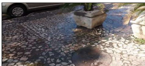
Figura 90. Transbordamento de esgoto na Bacia da Pajuçara. Fonte: Milena Bandeira de Melo
