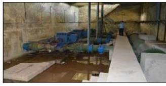
Figura 52. Bombas da Estação de Bombeamento de Água Bruta. Fonte: MJ Engenharia.
