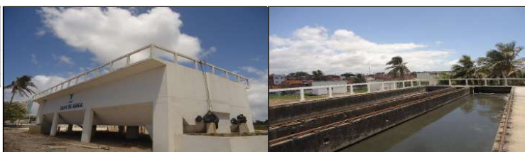
Figuras 83 e 84. Vistas da caixa de areia da ETE – Disposição Oceânica. Fonte: MJ Engenharia
