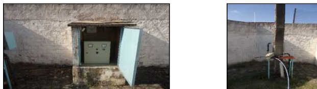
Figuras 107 e 108. Detalhe do quadro de comando e das instalações elétricas da EEE – Santo Eduardo. Fonte: MJ Engenharia
