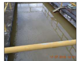
Figura 58. Câmara de Floculação. Fonte: MJ Engenharia.
