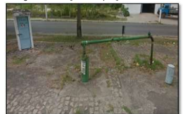
Figura 48. Poço de captação da CASAL
