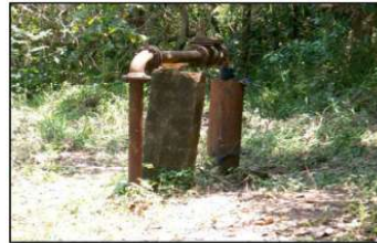
Figura 45. Poço de captação da CASAL
