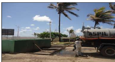
Figura 75. Recebimento de Efluentes de Fossa na Câmara de chegada da ETE. Fonte: MJ Engenharia
