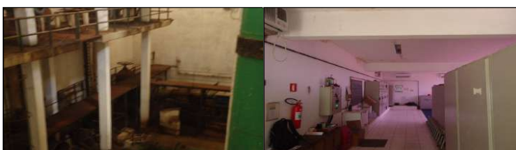
Figuras 81 e 82. Os 2 GMBs que formam o conjunto Emissário III e sala do operador. Fonte: MJ Engenharia
