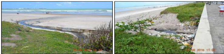
Figuras 142 e 143. Línguas sujas encontradas nos bairros Prado e Centro, respectivamente. Fonte: MJ Engenharia
