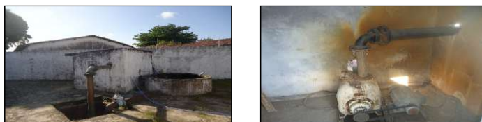
Figuras 105 e 106. Vista geral e do GMB da EEE – Santo Eduardo. Fonte: MJ Engenharia
