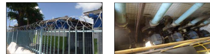
Figuras 96 e 97. Vista Geral e dos GMBs da EEE – Praça 13 de Maio. Fonte: MJ Engenharia
