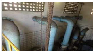
Figura 98. Detalhe das duas linhas de recalque diferentes da EEE – Praça 13 de Maio. Fonte: MJ Engenharia
