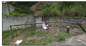
Figura 49. Poço de captação da CASAL
