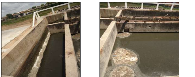
Figuras 85 e 86. Detalhes da Caixa de Areia em funcionamento. Fonte: MJ Engenharia
