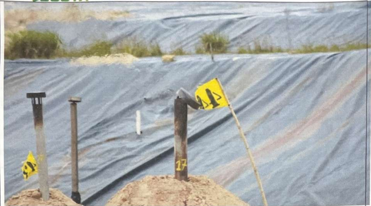
Figura 7: Péssimas condições dos drenos de gases.
