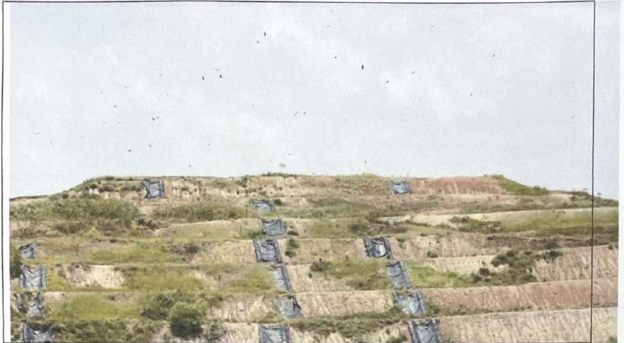
Anexo VII: Ausência de manutenção nos taludes e a presença constante de vetores ao fundo da imagem.
