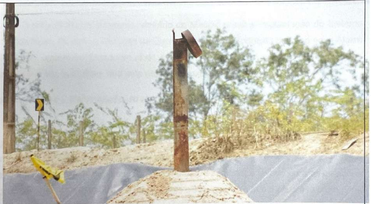
Figura 6: Péssimas condições dos drenos de gases.
